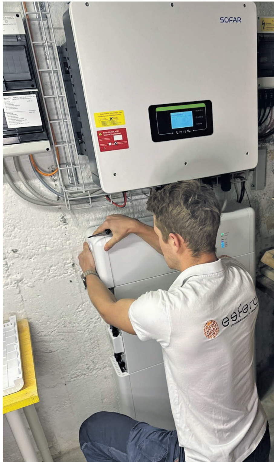
esfera Bauleiter Numa Minder bei der Arbeit mit einer 10 kWh-Lithium-Batterie.
