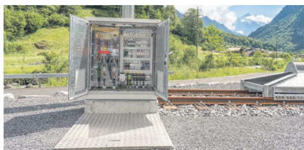
Bürki-Steuerschrank an der BOB-Bahnlinie.
